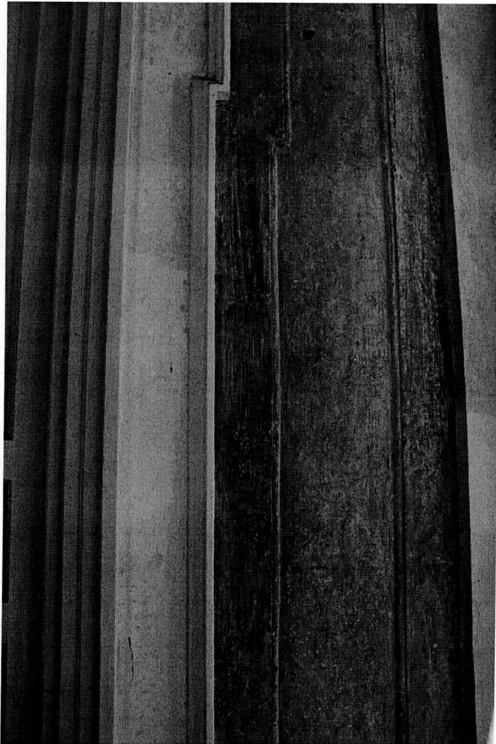
Particolare parete piano superiore scalone monumentale, Ritocco pittorico di un precedente intervento di restauro alterato
