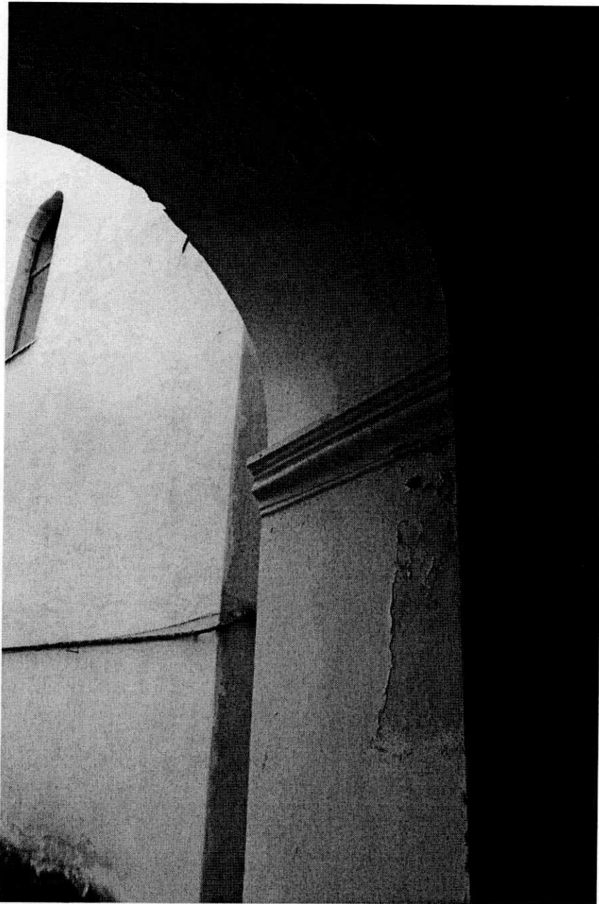
Particolare intonaco scalone monumentale, sollevamenti e distacco dell'intonaco.
