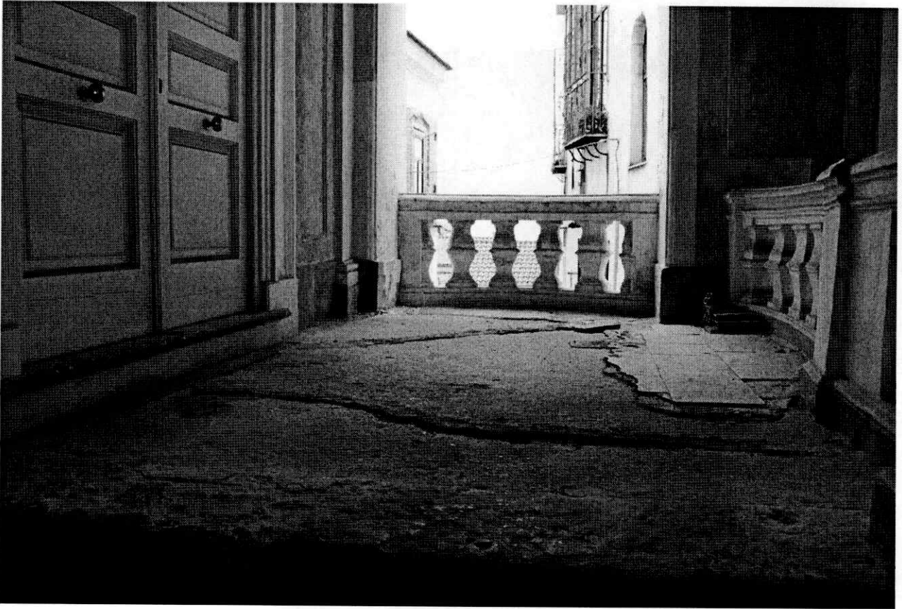
Particolare dello scalone monumentale, mancanza della pavimentazione e presenza di tracce dell'impianto elettrico
