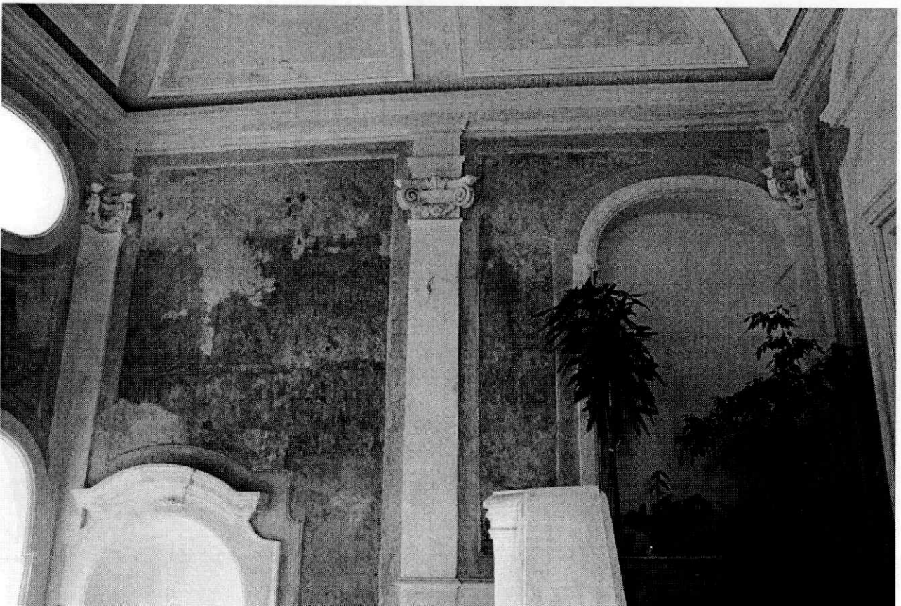
Particolare parete dello scalone monumentale, gore di umidità, alterazioni cromatiche, deposito superficiale diffuso.
