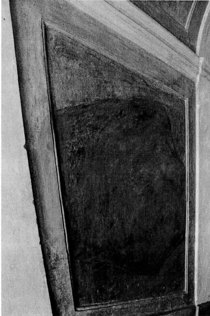
Particolare scalone monumentale, ritocco pittorico di un precedente intervento di restauro alterato.
